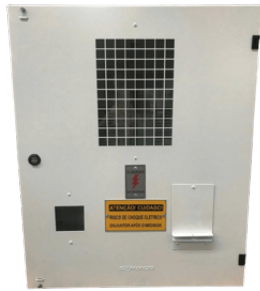
Quadro de medição
